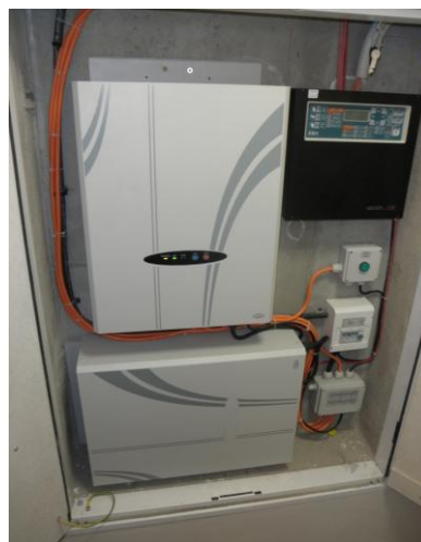
Umístění modulovému zdroje do min. prostoru. Napájení vent. 2600VA/45min
