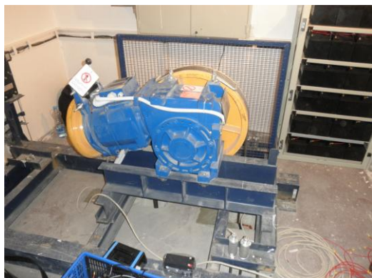
Rectifier 20 kVA pro napájení výtahu Domu s pečovatelskou službou Realizováno s firmou Výtahy Ostrava, Amsoft
